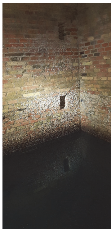
Vistes de la sala o cambra final de la galeria bastida de maons massissos
